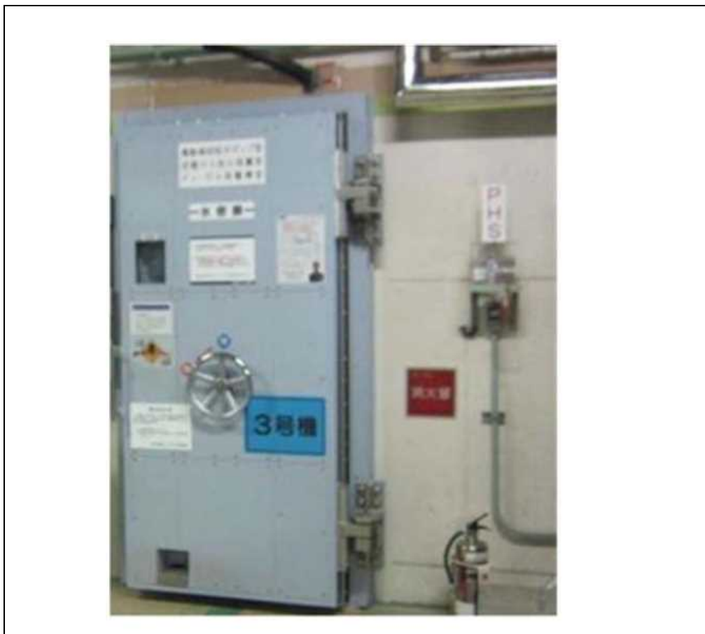
図 6.19 水密扉の設置例（関西電力 美浜 3号炉）
